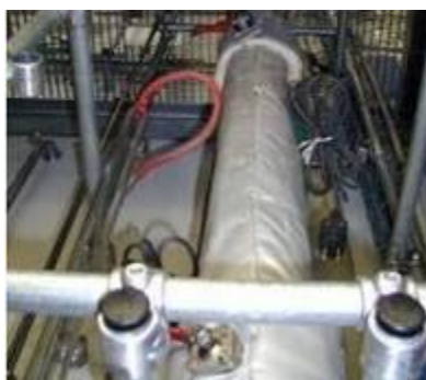
Colonne de distillation réactive. Copyright Rhodia
