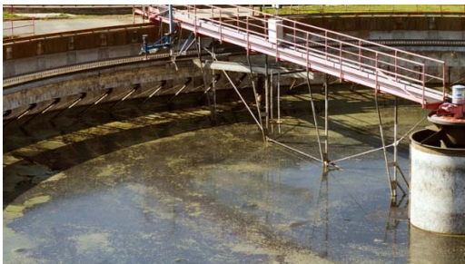
1 Une station d'épuration pour assainissement des eaux
