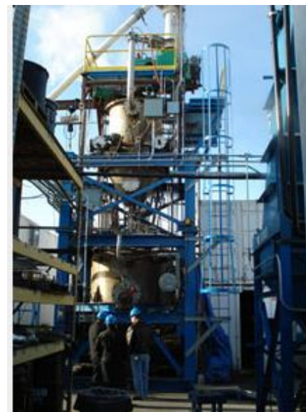
Usine de démonstration de valorisation des déchets transformés en biogaz
